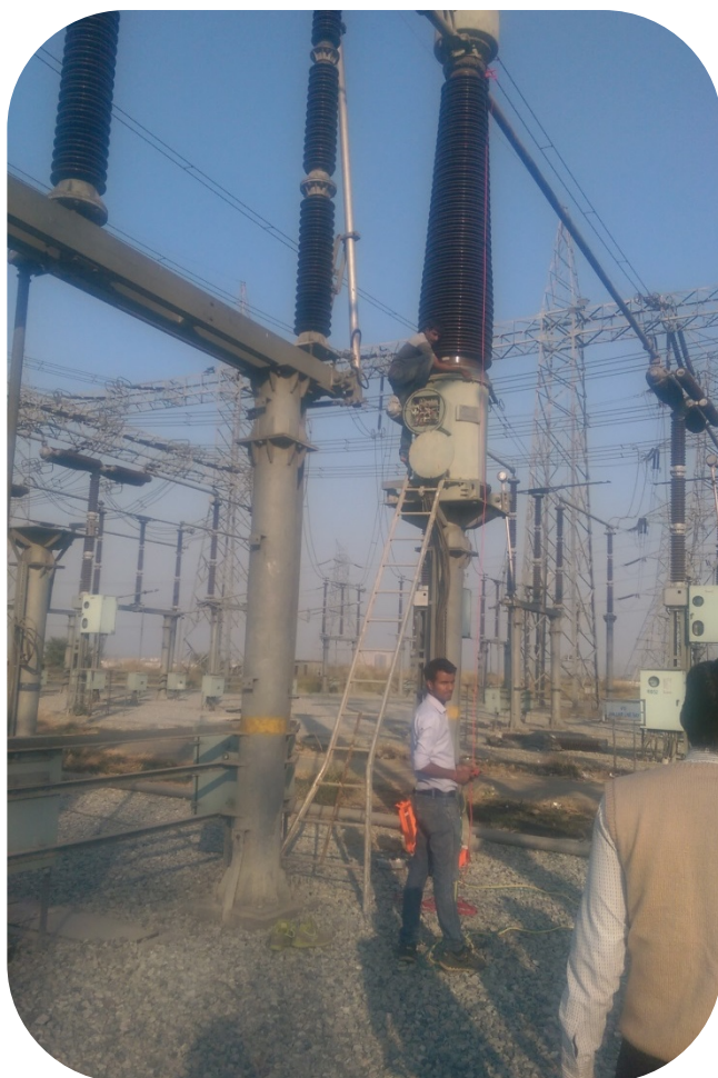
2000:1 ,400KV CT ,S/S
