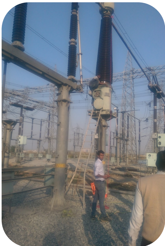
2000:1 ,400KV CT ,S/S
